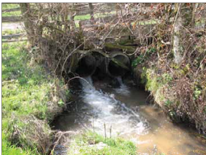
Photographie 26 : Ouvrage de franchissement avec double buses mal calées sur le ruisseau des Etiveau :
