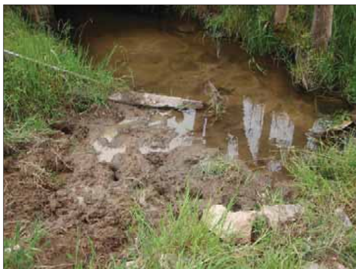
Photographie 5 : Zone de piétinement des berges et du lit sur le ruisseau du Colombier :
