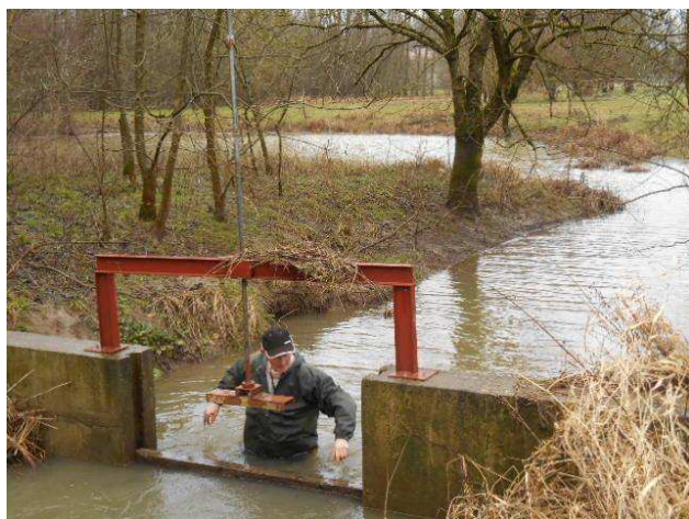
Photographie 9 : seuil amovible implanté sur le Bief Colas à Jouvençon et système de blocage des planches
