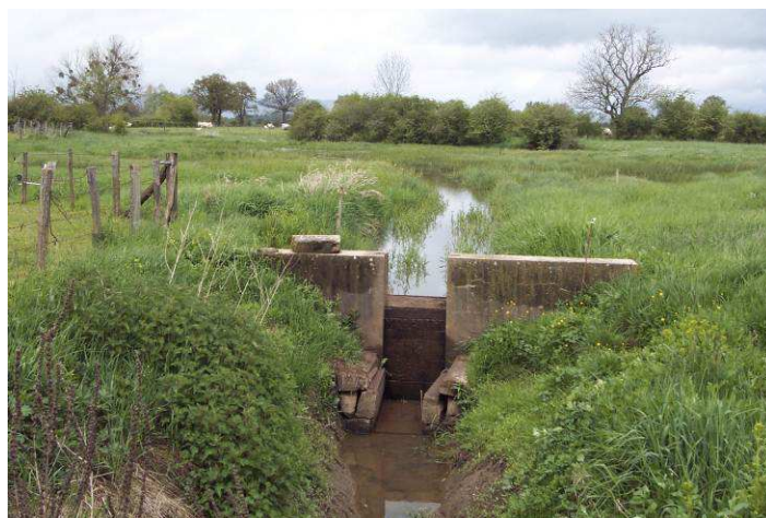
Photographie 8 : seuil amovible implanté sur la zone humide de Prély le long de l'Arroux à AUTUN
