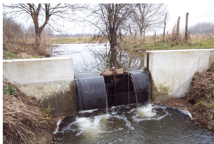
Photographie 9 : Ouvrage du bief Colas le 2 mars 2009, non franchissable par les brochets
