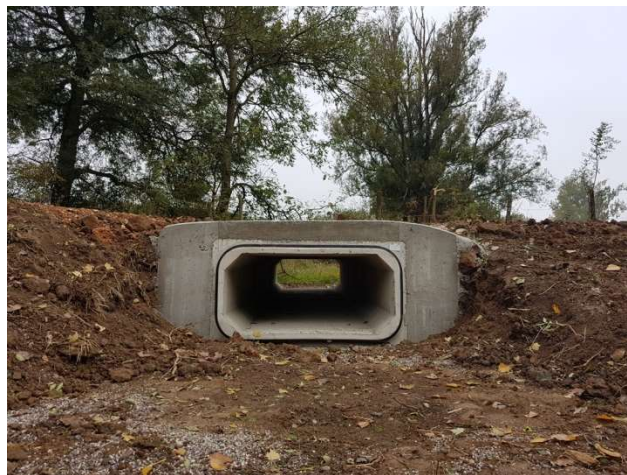
Busage installé sous le chemin d'accès pour faciliter les déplacements du poisson au sein du bras mort
