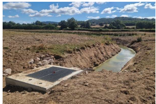
Travaux de terrassement d'un fossé et pose d'un ouvrage de gestion hydraulique
